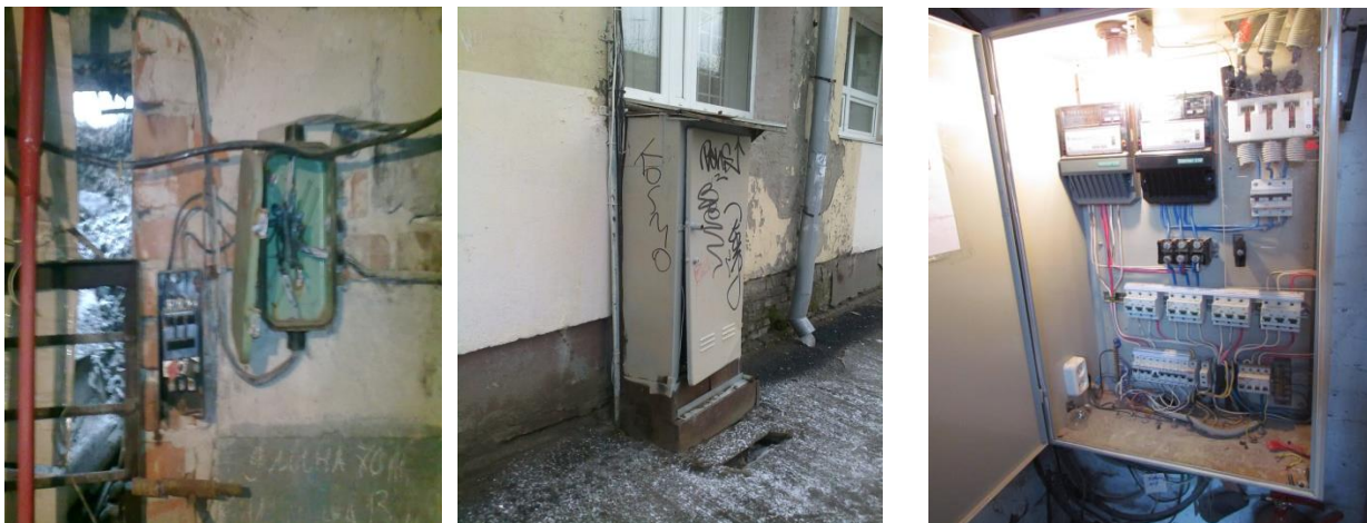
(а) Состояние вводов и электропроводки в отдельных жилых зданиях гг. Тюмень и Ростов-на-Дону
